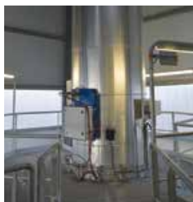
La cheminée et les analyseurs de fumées
